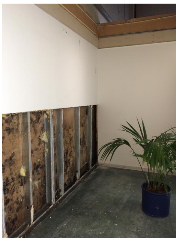
Figur 2: Skjult vækst af skimmelsvampe i skillevægskonstruktion. Foto: Teknologisk Institut.
