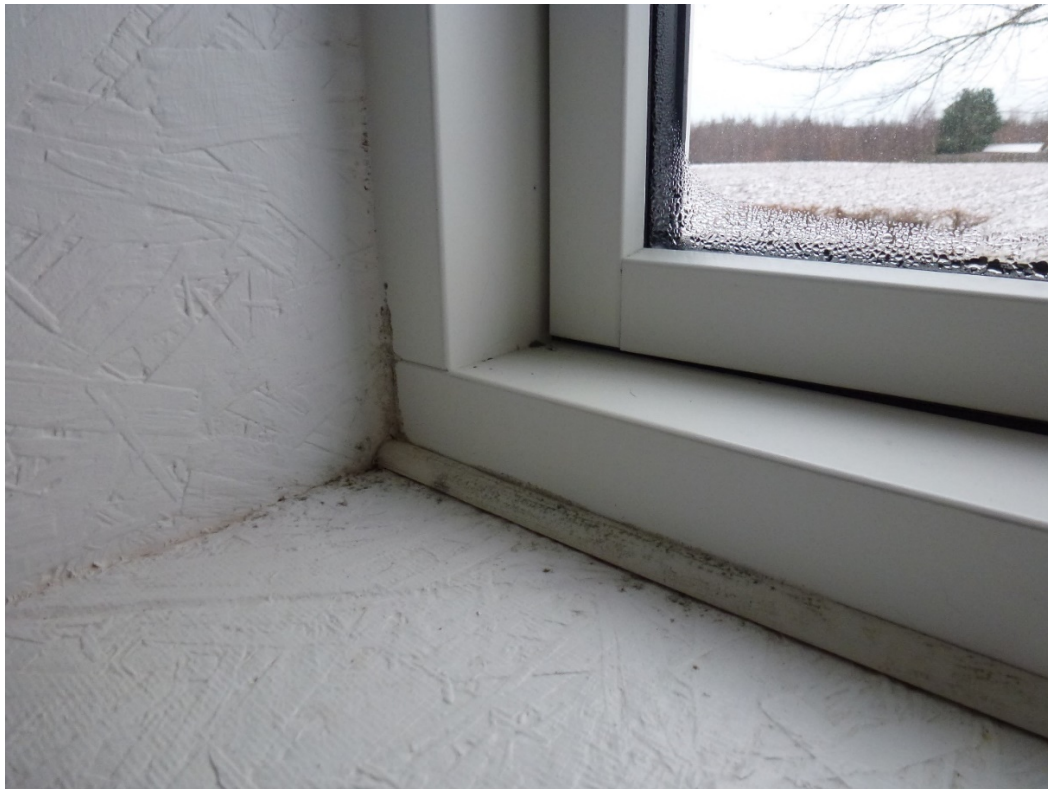
Figur 4. Vindue med tydelig kondens og grå-sort skimmelsvampevækst på listen mod vinduesrammen og den tilstødende væg (Foto: Lars Gunnarsen).
