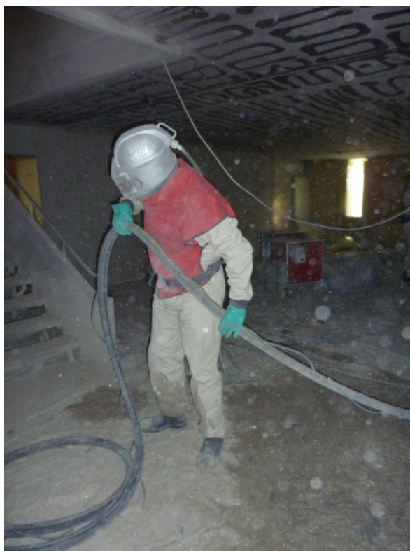
Figur 5. Renoveringsarbejder i beskyttelsesdragt med friskluftforsyning i gang med at fjerne PCB-holdig maling fra betonoverflader ved sandblæsning (Foto: Marie Frederiksen).
