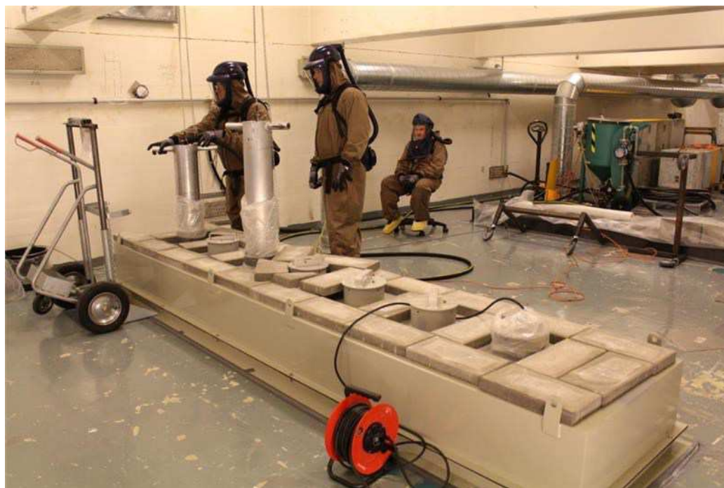
Figur 4. Fjernelse af lukkeanordninger der adskilte rummene (cellerne) på Hot Cell-anlægget under drift. Billedet viser lukkeanordningerne på etagen over selve Hot Cell-anlægget. Foto: Dansk Dekommissionering
